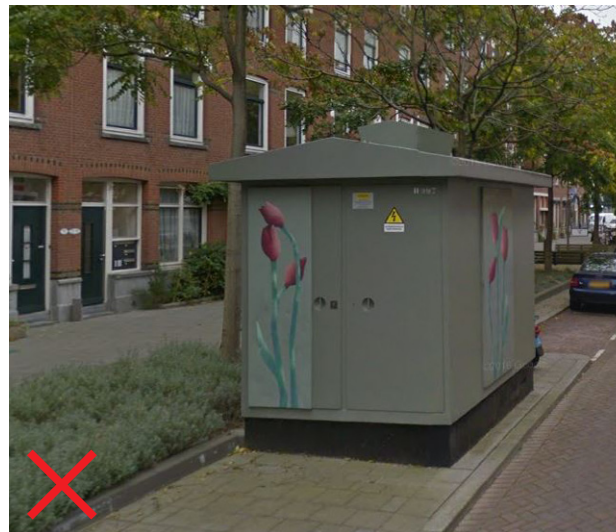
Transformatorhuisje in de openbare ruimte
