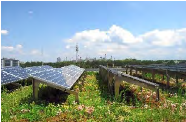
Zonnepanelen op groen dak
