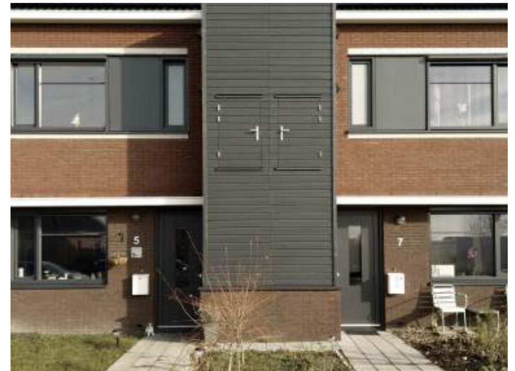
Warmtepomp geïntegreerd in de architectuur
