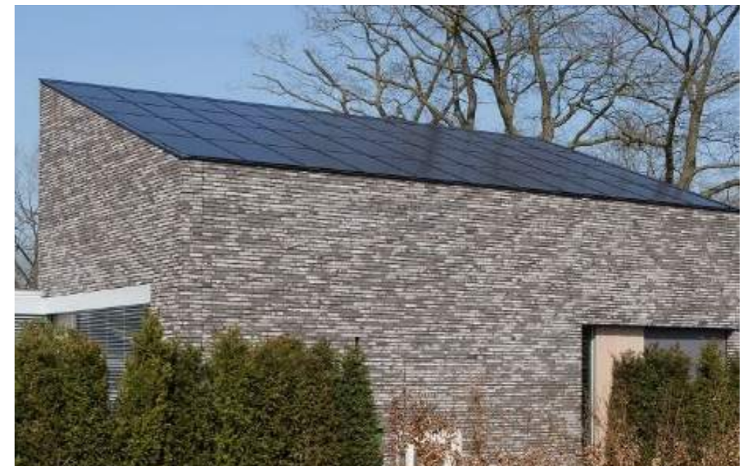
Schuin dak met PV-panelen bron: TNO Cauberg Huy, Lincolnpark, mei 2021
